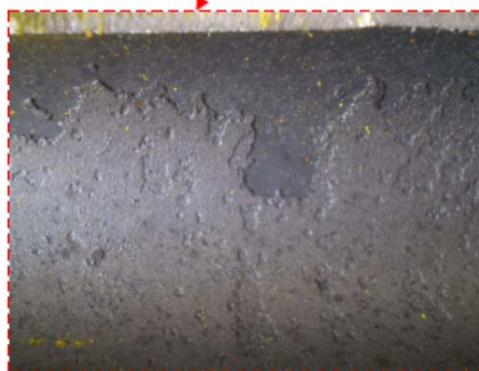
Foto da superfície interna com camada espessa de coque.
