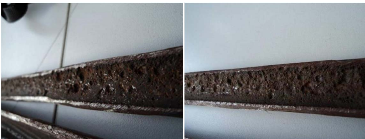
Figura 16 – Exemplo de tubos com corrosão alveolar interna.(3)
